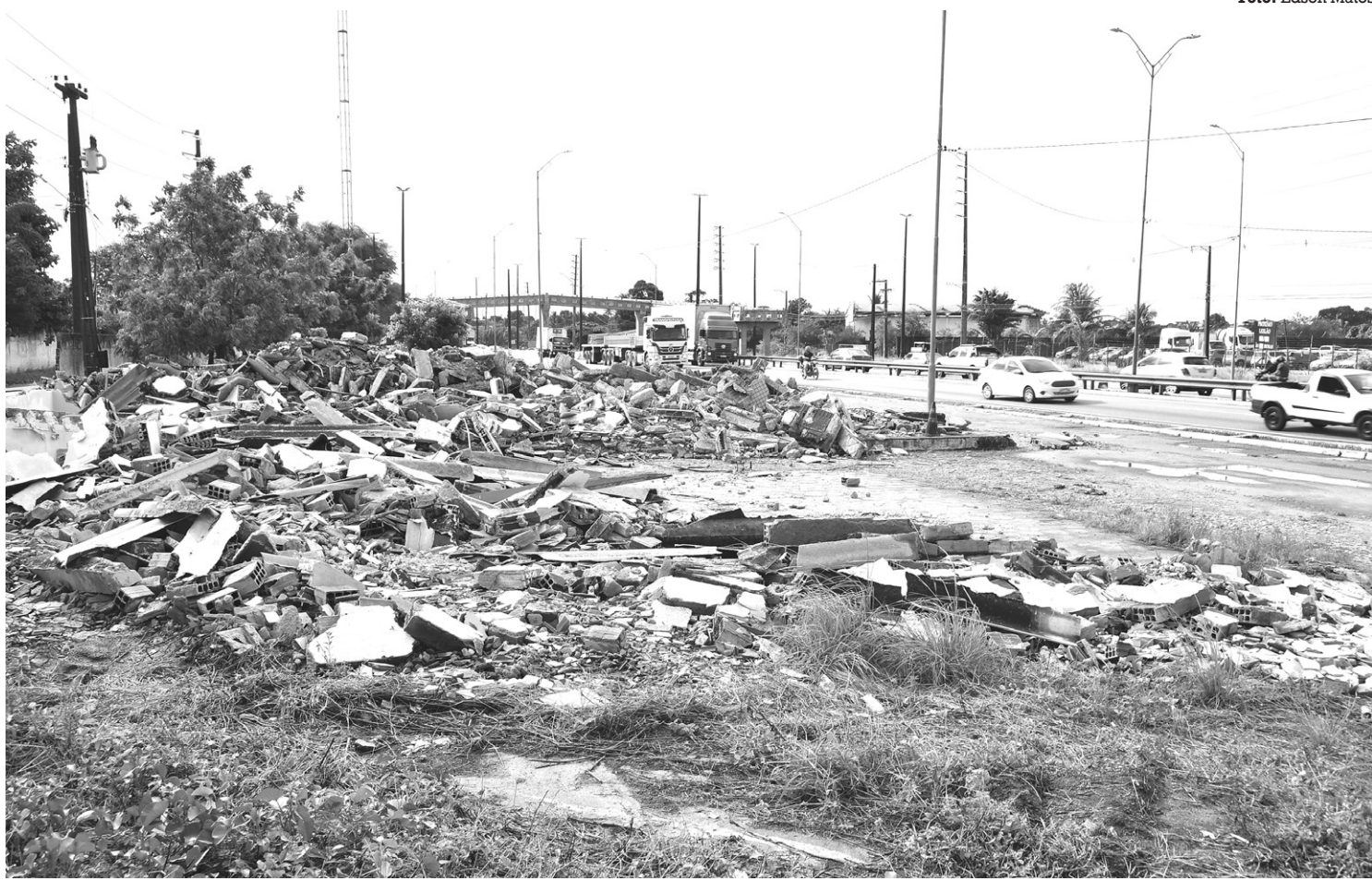
Escombros da estrutura do antigo posto da PRF; moradores da área dizem que o local só servia atualmente como ponto de referência
